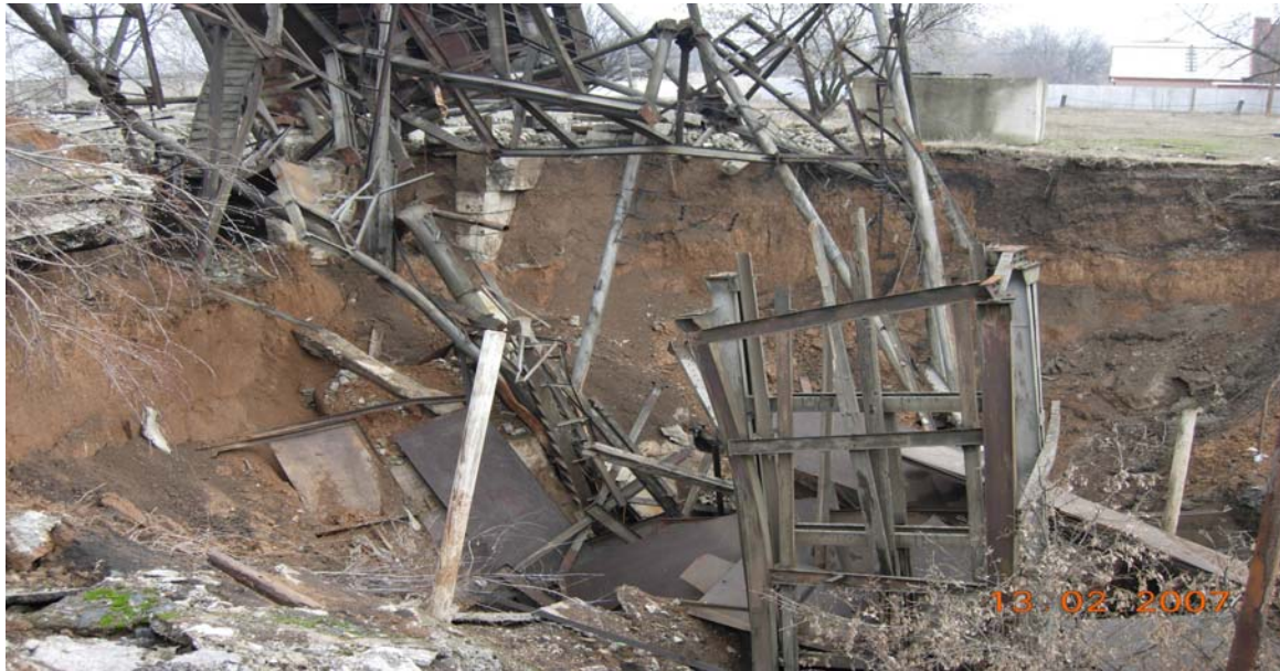
Рис. 2. Провал “нулевой” рамы вместе с шейкой ствола и стаканом крепления восточного воздухоподающего ствола
