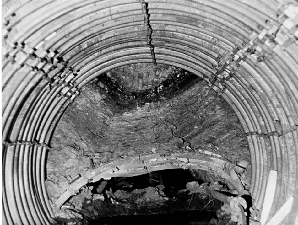
Рис. 2. Образование клина выдавливания пород кровли в условиях шахты «Западно-Донбасская»
