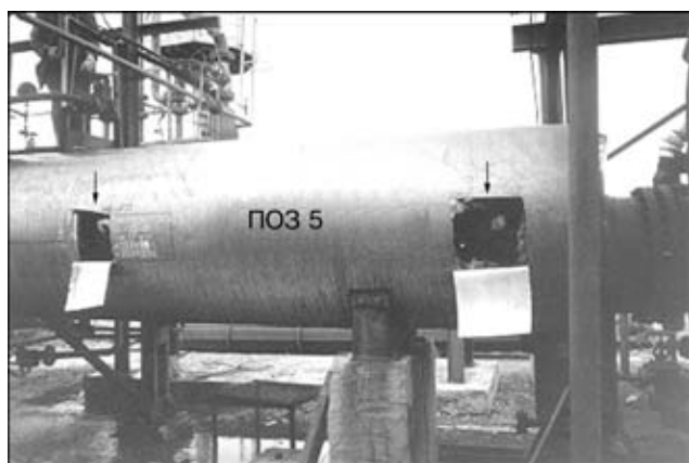
Рис. 1. Теплообменник (места установки АЭ датчиков показаны стрелками)
