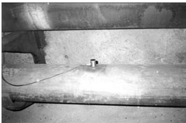
Рис. 5. АЭ датчик на поверхности трубопровода
