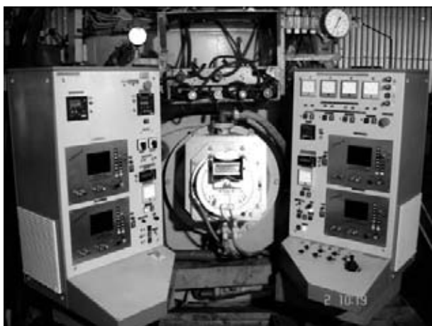
Рис. 2. Главный пульт управления установкой TICO-15M
