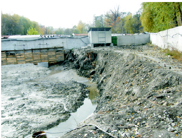
Рис. 1. Истоки грунтовой воды на территории строительной площадки
