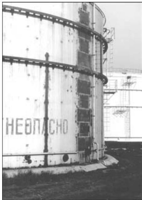
Рис. 1. Общий вид участка стенки резервуара вместимостью 20 тыс. м 3 со специальными вставками вместо монтажного стыка в одну линию
