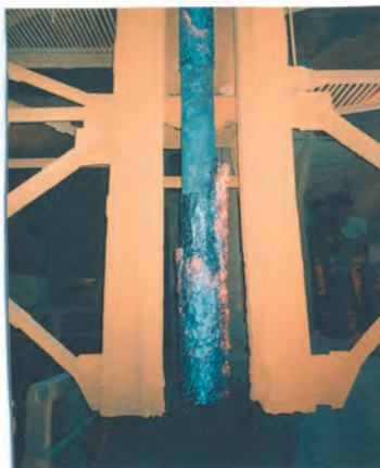
В – Вид фурмы на плавке №234836 с электрическими воздействиями на первой повалке конвертера
