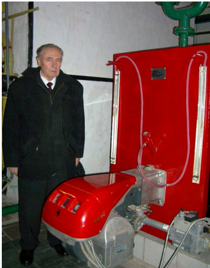
Водогрійний водотрубно-димогарний котел КВД-0,63 Гн теплопродуктивністю 0,63 МВт для потреб опалення та гарячого водопостачання, розроблений в ІТТФ НАН України
