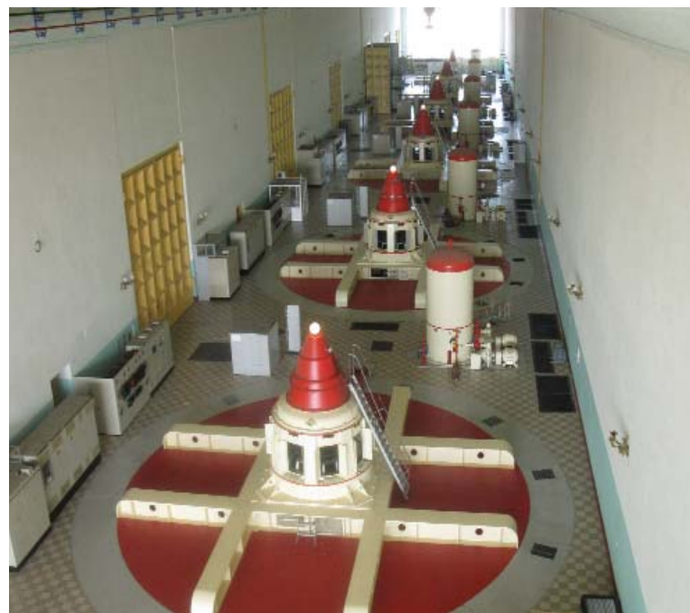
Каховская ГЭС - машинный зал
