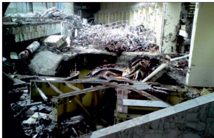
Рис. 2. Машинный зал С-Ш ГЭС после аварии (фото – http://nignews.com.ua->novostey.com )
