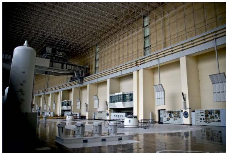
Рис. 1. Машинный зал С-Ш ГЭС до аварии (фото – http://bigpicture.ru/?p=4962 )
