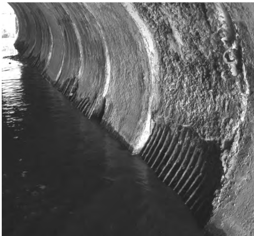
Рис. 5 – Разрушение бетона, обнажение и коррозия арматуры
