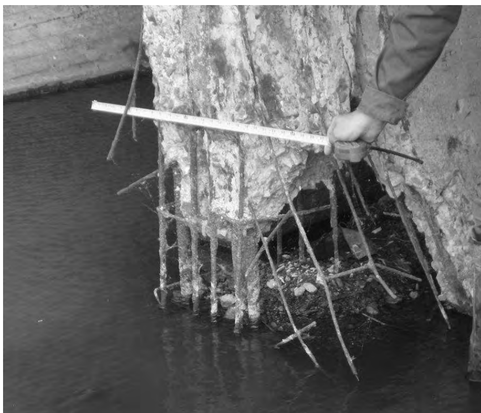
Рис. 6 – Разрушение порталной стенки выходного оголовка
