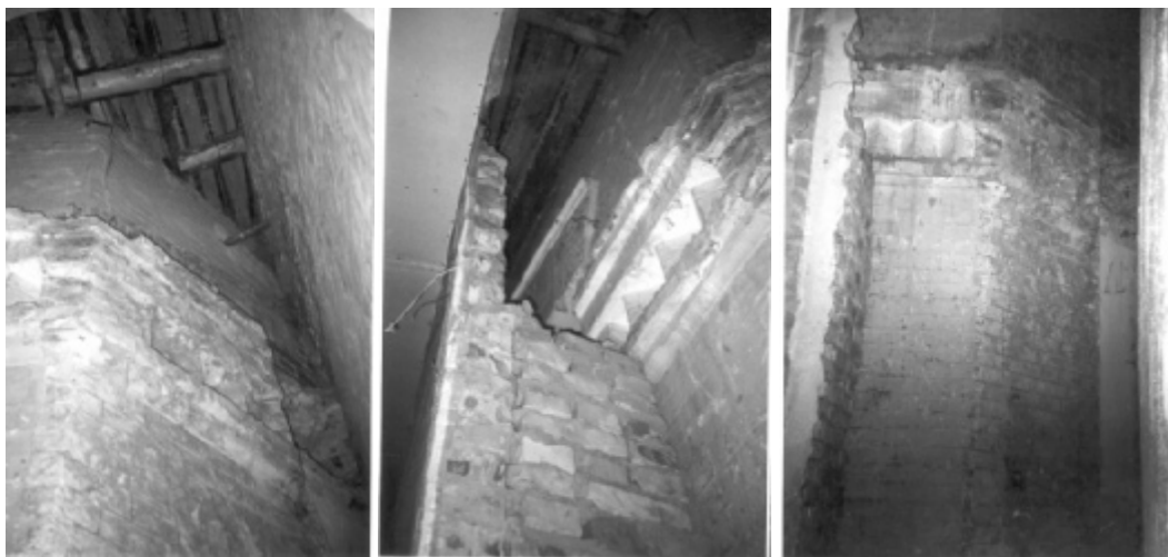
Рис. 5. Пролом на першому поверсі будинку НДІ, права частина стіни з опалубкою.
