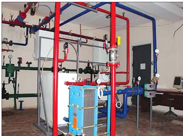
Рис. 7. «Розумний» індивідуальний тепловий пункт тепловою потужністю 250 кВт, оснащений електричними котлами
