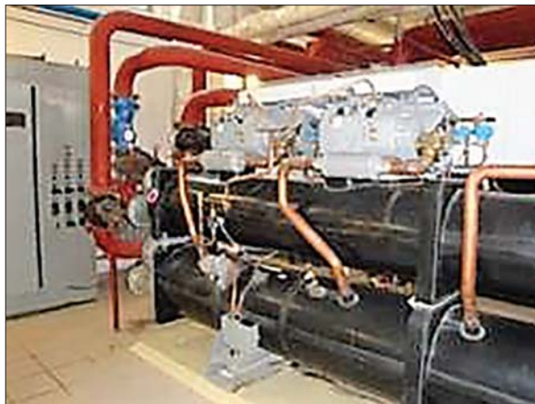
Рис. 5. Теплонасосна система гарячого водопостачання потужністю 1,5 МВт в м. Краматорськ
