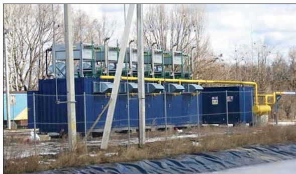
Рис. 2. Комплекс з переробки звалищного газу потужністю 1 МВт (Київська область)
