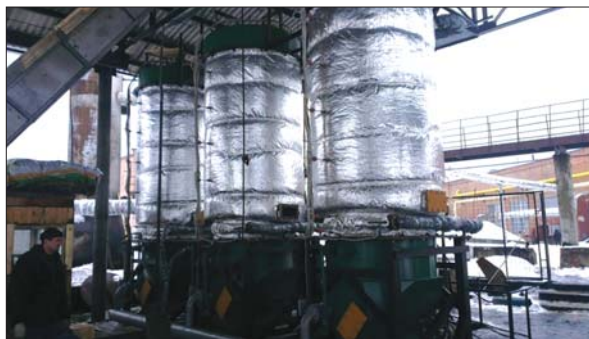
Рис. 1. Газогенератор експлуатаційною потужністю 2 МВт, встановлений на Малинській паперовій фабриці
