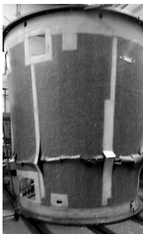
Рис. 4. Характер разрушения переходного отсека.
