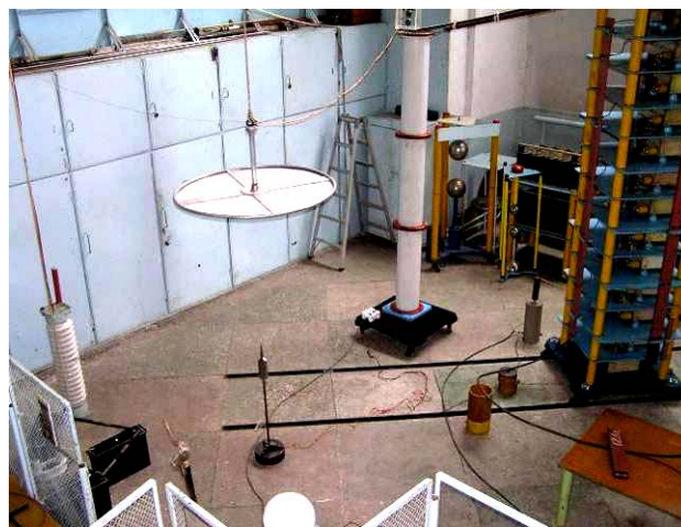
Рис. 9. Общий вид высоковольтного испытательного стенда НИПКИ «Молния» НТУ «ХПИ», предназначенного для испытания средств молниезащиты технических объектов коммутационным аperiodическим импульсом напряжения амплитудой до \pm 1 МВ временной формы 250 мкс/5000 мкс и содержащего в схеме передвижной сверхвысоковольтный емкостный делитель напряжения типа ЕДН-1,2 [16]
