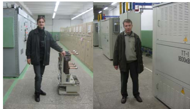
Во время экскурсии на тяговую подстанцию Харьковского метрополитена
