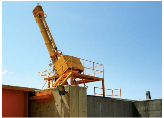
Рис. 2. Гидропривод г.п. 270 т. аварийно-ремонтного затвора водоприемника ГЭС Эль Кахон, Мексика
