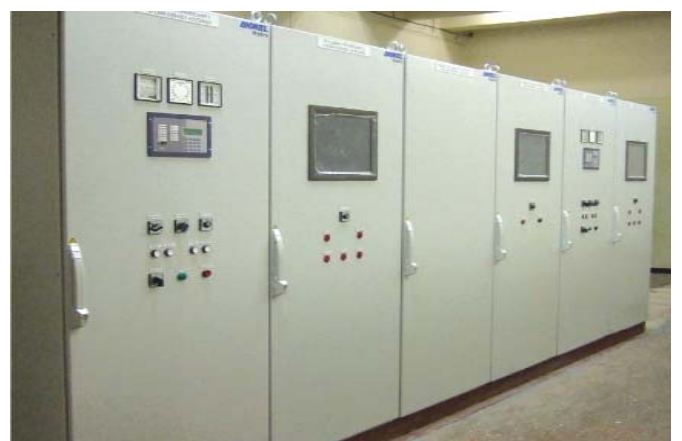
Рис. 3. Щит автоматики после модернизации
