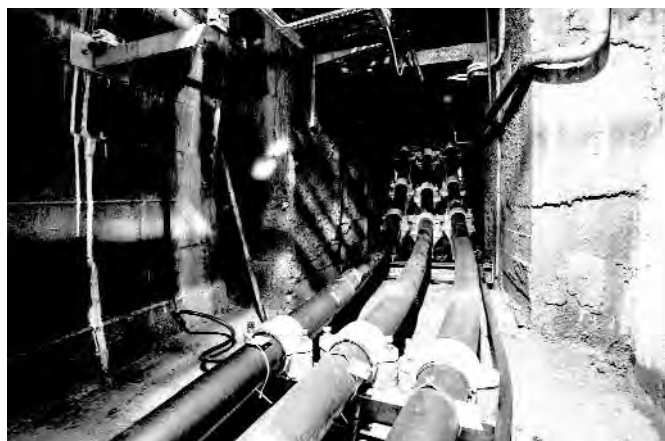
Рис. 1. Силовые кабели с изоляцией из сшитого полиэтилена производства АВВ "Energiekabel", используемые на Бурейской ГЭС (Россия), [1].
