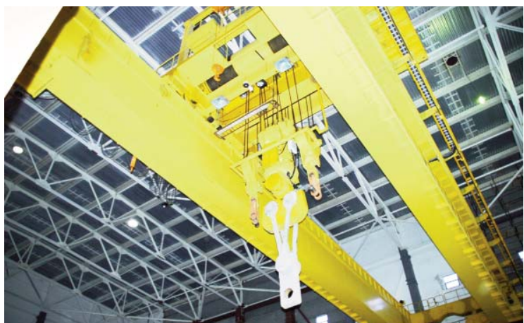
Рис. 4. Запорожская АЭС. Кран мостовой г.п. 180/2x70 т.
