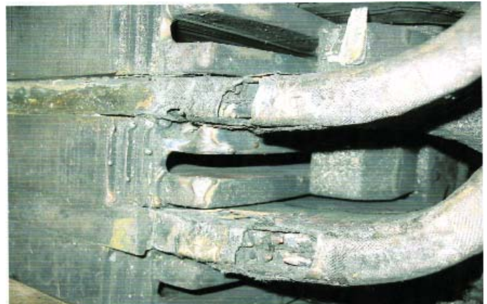
Рис. 2. Пошкодження обмотки статора гідрогенератора при руйнації демпферних стержнів ротора
