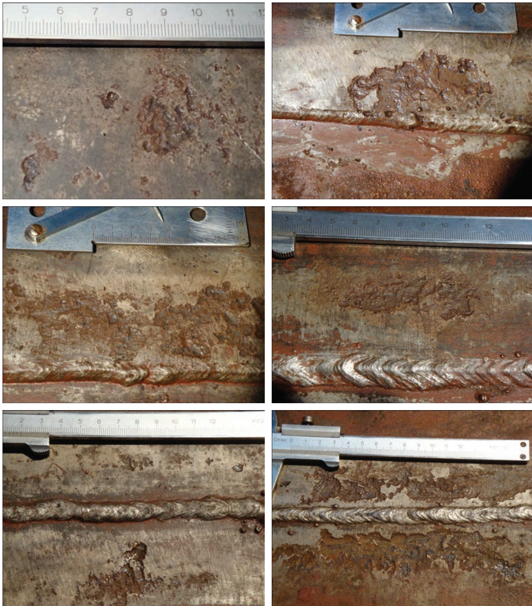
Рис. 4. Загальний вид корозійних пошкоджень днища
