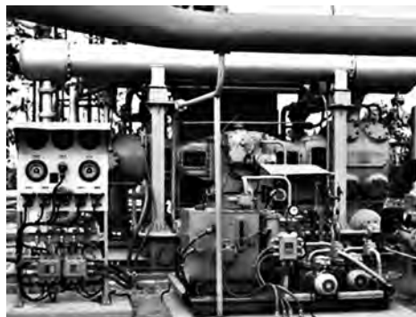
Рис.7. Общий вид установки очистки биогаза.
