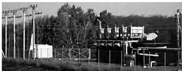
Рис.8. Станция переработки свалочного биогаза в электроэнергию (полигон ТБО № 5).
