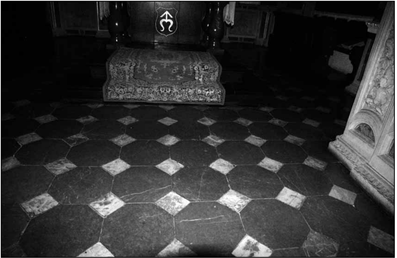
Рис. 11. Підлога бічної нави костелу св. Петра і Павла, викладена двоколірними мармуровими октагональними та малими квадратними плитками
