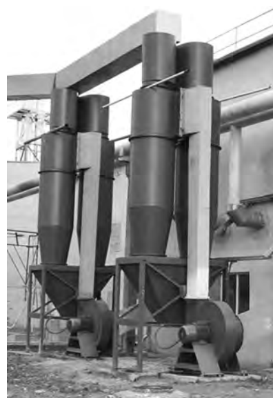
Рис.2. Циклонные фильтры котлов КСВа-2,9Р.
