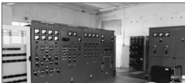
Рис. 3. Шафа системи моніторингу поряд із щитом керування ТП
