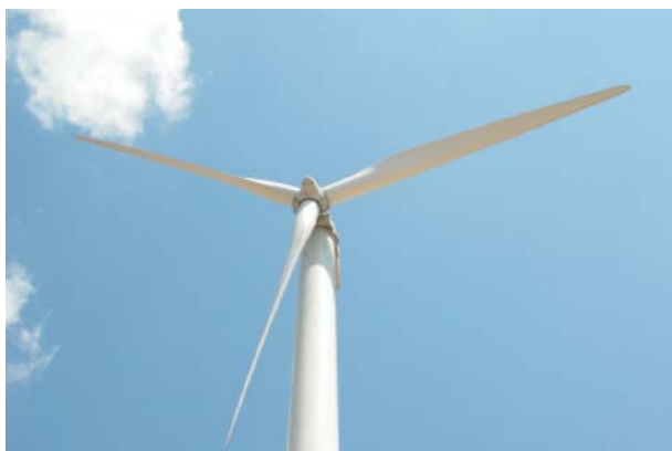
Рис. 7. Ветроэлектрическая установка Turbowinds T600-48 мощностью 600 кВт
