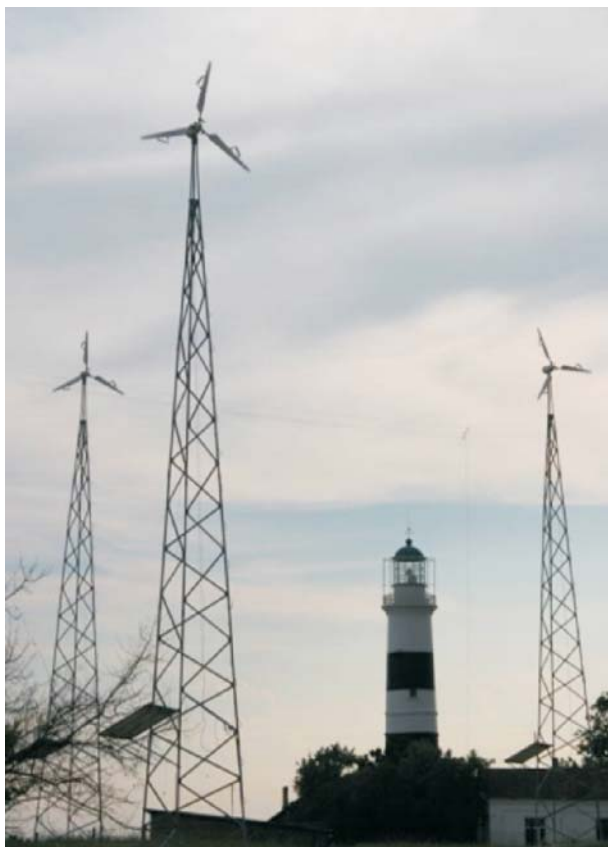
Рис. 5. Комплексный узел энергообеспечения мощностью 4,5 кВт. Остров Тендровская коса
