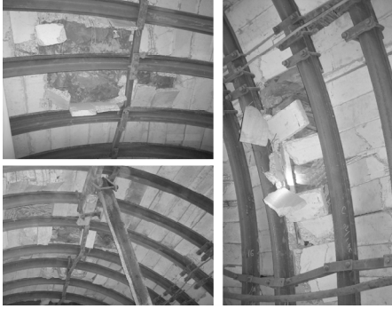
Рис. 1. Деформация межрамных затяжек
