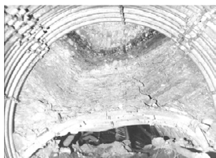
Рис. 2. Состояние расчески полевого штрека на шахте «Западно-Донбасская» ГХК «Павлоградуголь»
