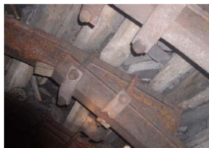
Рис. 4. Разрушение планки замка АПЗ.030 (шахта им. Вахрушева)
