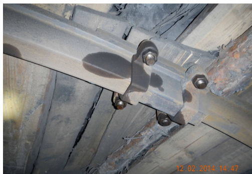
Рис. 2. Внешний вид замкового соединения ЗСГ-27 на оvoidной креpi КМП-АЗР2-16, 1 в конвейерном уклоне пласта L 4 блока №5 шахты «Комсомолец Донбасса»
