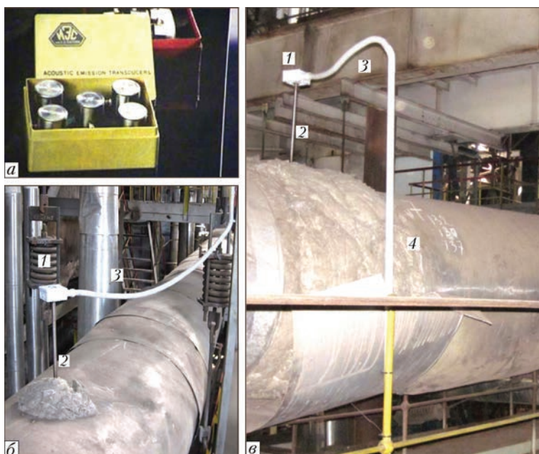
Рис. 3. Установка АЭ датчиков (а) на трубопроводе: датчик 1 в специальном коробе, установленном на приваренном к трубопроводу волноводе 2; соединительный кабель в гибкой изоляции 3 (б), в жестком коробе 4 (в)
