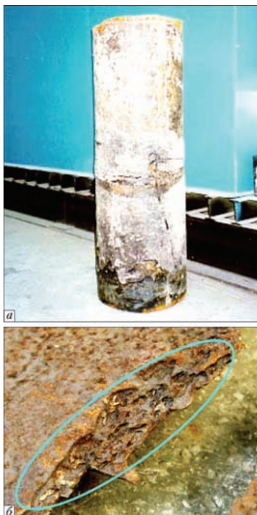
Рис. 1. Элемент трубы после длительной эксплуатации (а) и поверхность разрушения (б)
