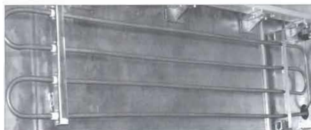
Рис. 1. Общий вид криозмеевика, смонтированного на задней стенке вакуумной камеры установки КЛ-132 (внизу справа — «холодный ввод» в вакуумную камеру)
