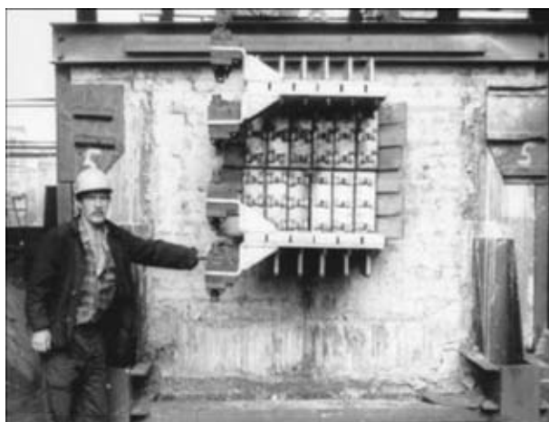
Рис. 9. Контактная сборка печи синтеза карбида кремния, выполненная с применением ЭКП
