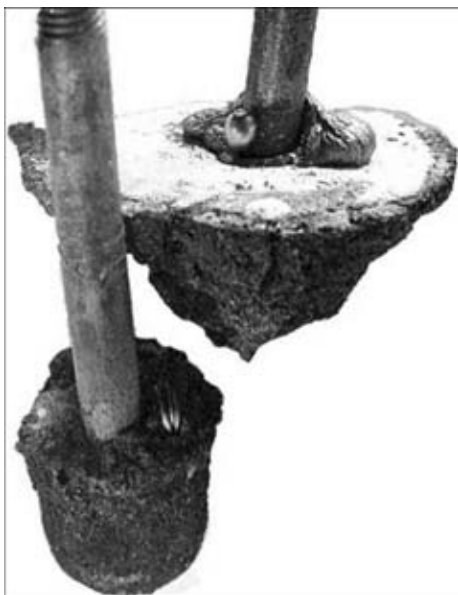
Рис. 3. Внешний вид пробок после испытания на вырыв: верхняя — выполнена с соблюдением технологии; нижняя — с нарушением
