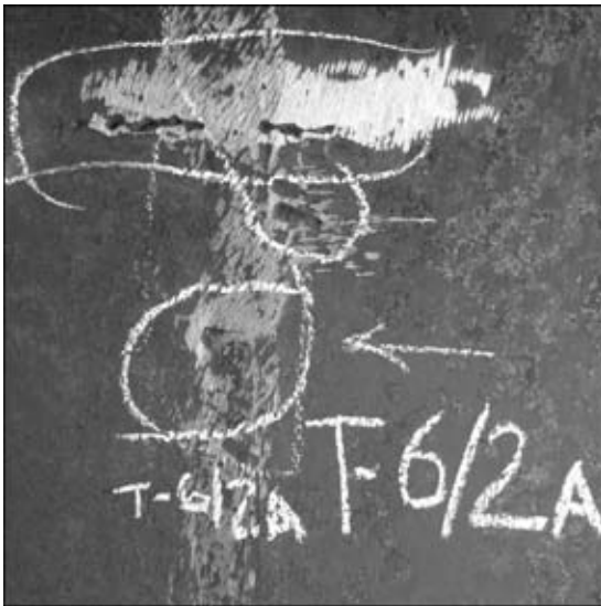
Рис. 8. Высокотемпературное растрескивание сварного шва теплообменника, изготовленного из стали 12ХМ, в зоне ремонтной подварки
