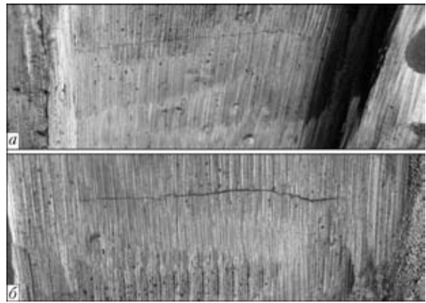
Рис. 9. Высокотемпературное растрескивание кольцевых швов в зоне фланцевого соединения (сталь 15Х5МУ) с обечайкой теплообменника (сталь 12ХМ) различной толщины: а — сварной шов приварки обечайки теплообменника к днищу толщиной 35 мм; б — сварной шов в зоне соединения обечайки толщиной 45 мм к фланцу
