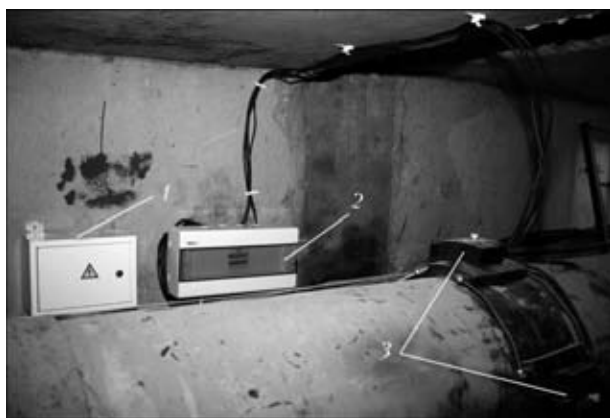
Рис. 3. Расположение корпуса аккумулятора (1), корпусов блока обработки и измерения сигнала (2), креплений преобразователей (3)
