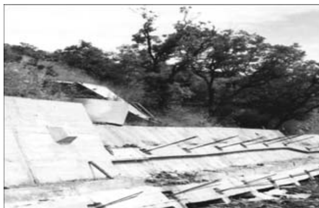
Рис. 1. Противооползневые анкерные сооружения в АРК
