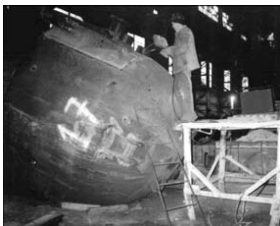
Рис. 4. Ремонтная сварка порошковой проволокой ПП-АН7 металлургического оборудования на ОАО «Днепропетровский металлургический комбинат им. Ф. Э. Дзержинского», г. Днепропетровск [5]
