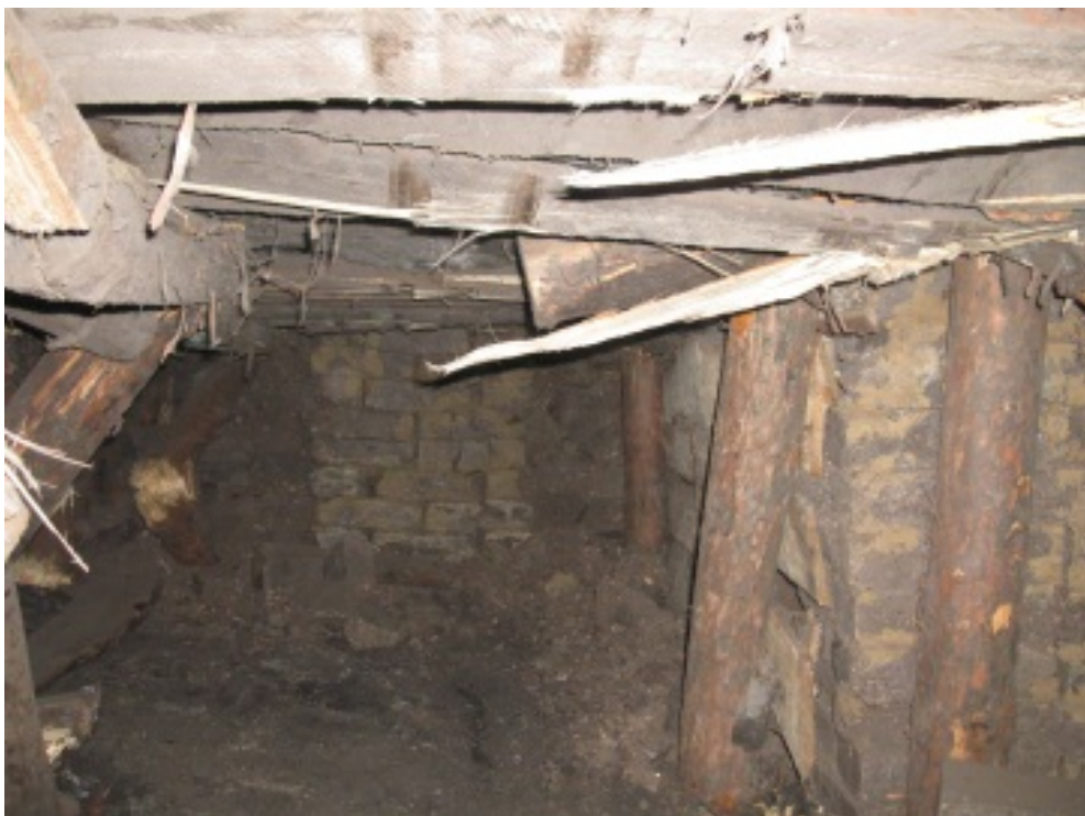
Рис. 9. Частичное разрушение полублоков в жесткой полосе
