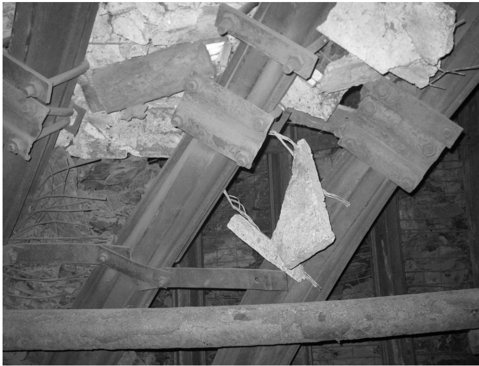
Рис. 4. Наклон рам крепи в конвейерном штреке 5 восточной лавы пл. m_3 гор. 915 м в условиях шахты «Щегловская-Глубокая» на участке перекрепления
