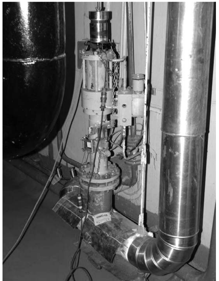
Рис. 3. Общий вид размещения генератора виброколебаний и сейсмодатчиков на пневмоприводе для выполнения динамических испытаний оборудования по месту эксплуатации
