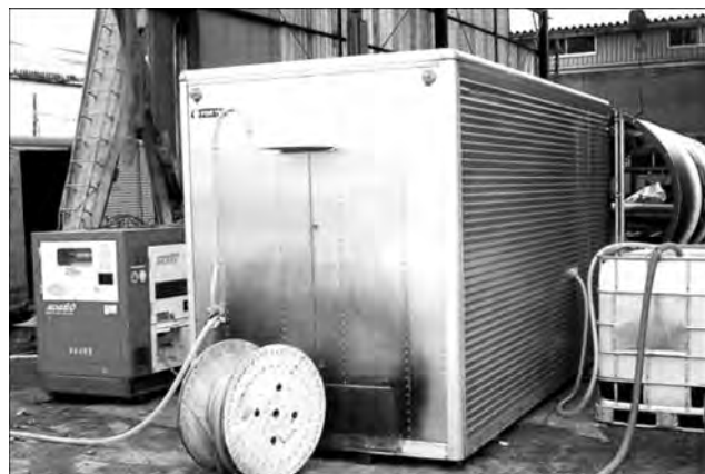
Рис. 1. Общий вид мобильной плазменной установки для очистки радиоактивно загрязненной воды
