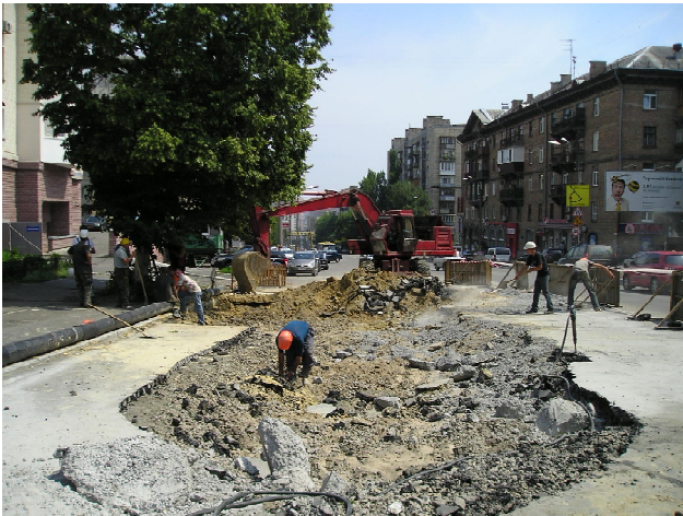
Рис. 1. Провал в интервале ПК 52+50 – 52+80 между станциями “Голосеевская” – “Васильковская”
