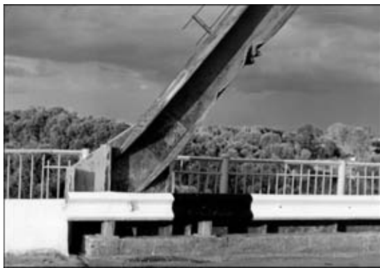
Рис. 8. Деформации опорного раскоса моста через р. Десну в г. Чернигове
