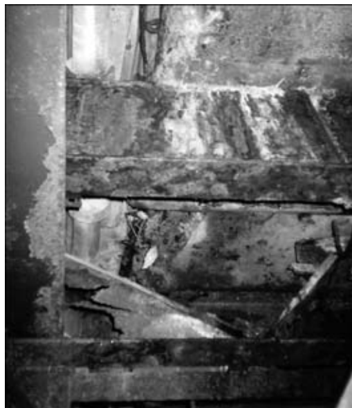
Рис. 3. Вид коррозионного повреждения поперечных балок моста им. Е. О. Патона
