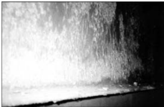
Рис. 1. Вид коррозионного повреждения на участке стенок главных балок моста им. Е. О. Патона
