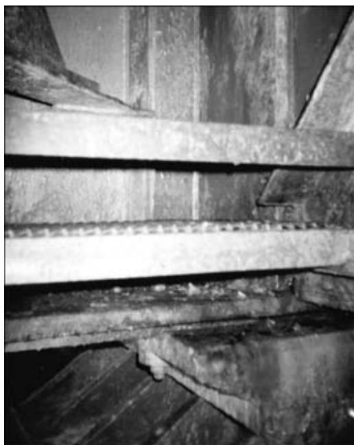
Рис. 2. Вид коррозионных повреждений поясов, ребер главных балок и элементов связей в надопорных участках пролетного строения моста им. Е. О. Патона
