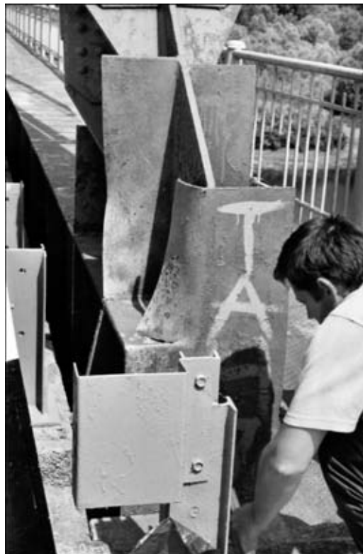
Рис. 9. Механические повреждения опорного раскоса моста через р. Десну в г. Чернигове
