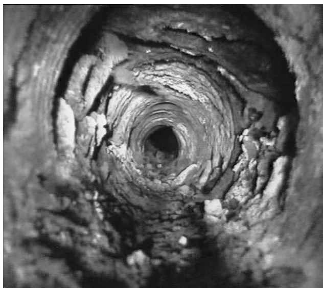
Рис. 7. Ствол скважины Ю-12-78, пробуренной в завале (отметка +12.000, ось 46 +2850 ). Ствол хорошо просматривается на всю глубину завала (ряды И – И +1500 ).
