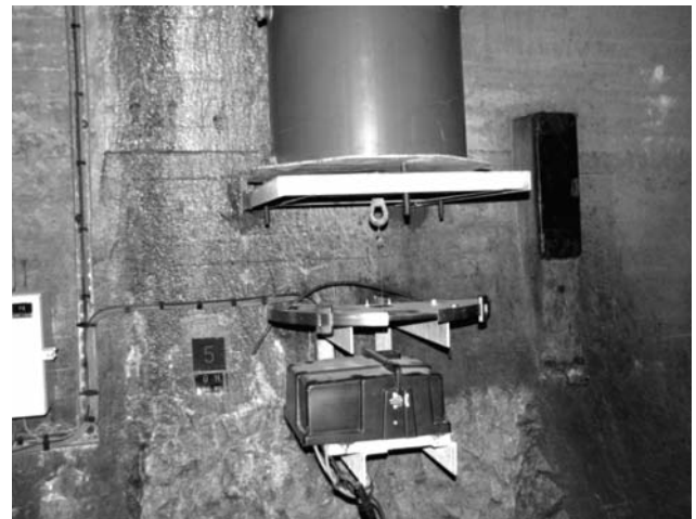
Рис. 4. Обратный отвес в галерее арочной плотины Тинь (Франция)
