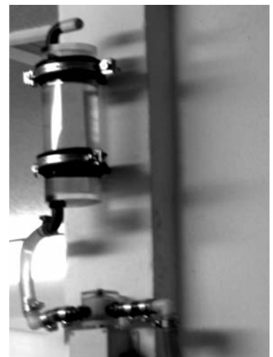
Рис. 6. Система гидростатического нивелирования, установленная в здании железнодорожного вокзала в г. Цюрих на период строительства туннеля под существующими сооружениями
