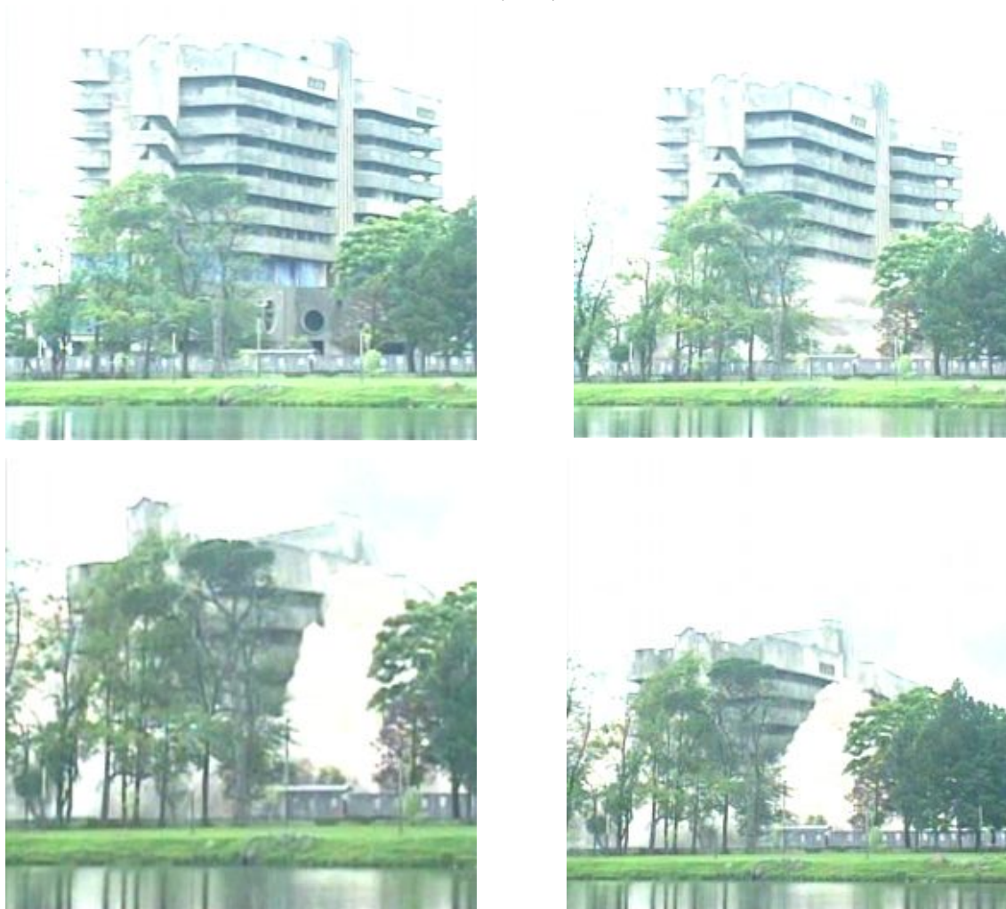
Рисунок 5 - Фрагменты взрывного разрушения здания гостиницы «Батуми»
