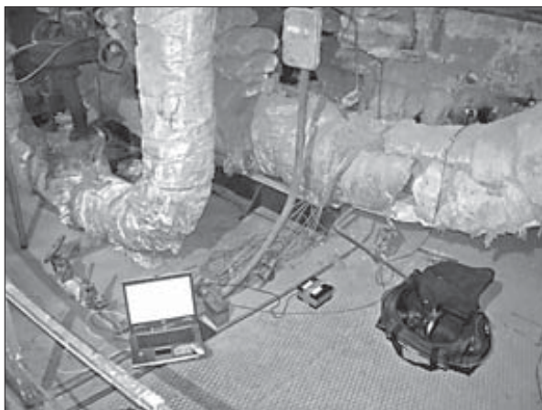
Рис. 6. АЕ-діагностування згинів трубопроводу живильної води енергоблока потужністю 300 МВт Ладизинської ТЕС
