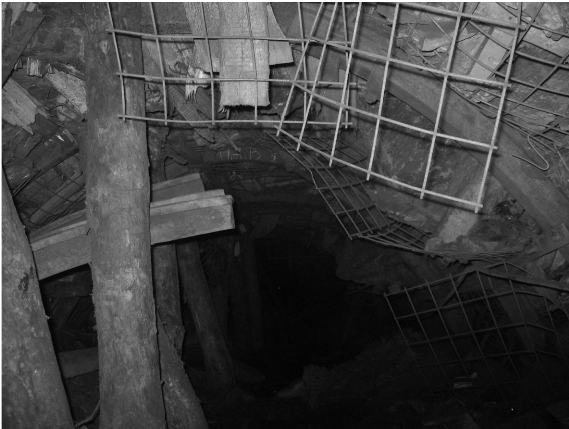
Рис. 4 – Состояние горной выработки в зоне ее сопряжения с выработанным пространством лавы
